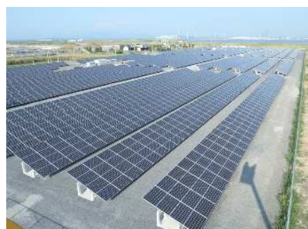
ひびきソーラーパワーの外観
