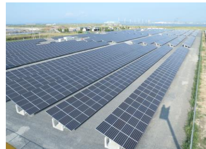
ひびきソーラーパワーの外観
