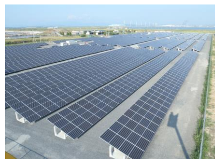
ひびきソーラーパワーの外観
