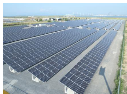
ひびきソーラーパワーの外観
